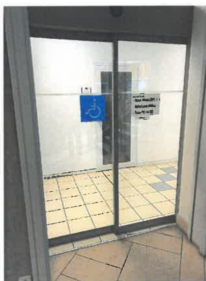
Porte coulissante pour accès PMR après la sortie de l'ascenseur
